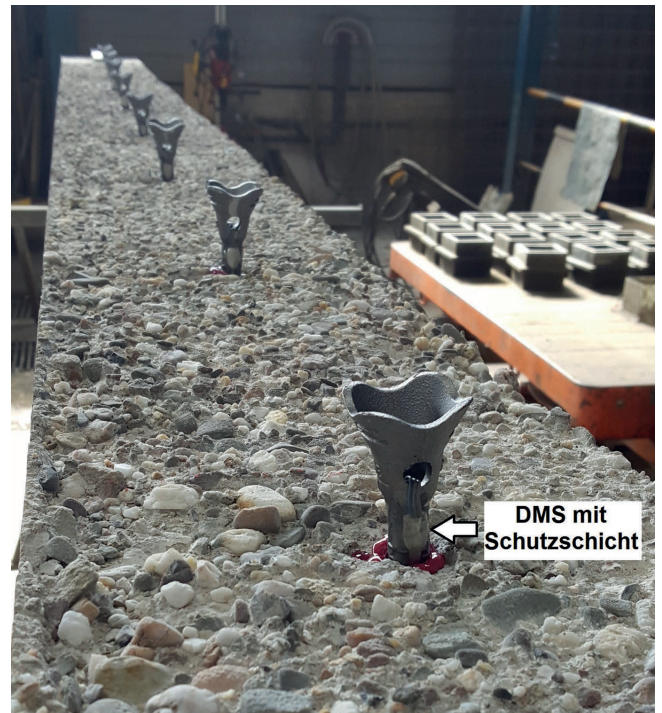
Bild 8. In Bohrlöcher geklebte HCC-B Schubverbinder mit DMS Abb.: Jens Heinrich Fig. 8. HCC-B shear connectors with strain gauges in drilled holes Source: Jens Heinrich
